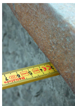
I pumpkammaren hade 3 – 4 centimeter betong slitits ned under decenniernas gång.
